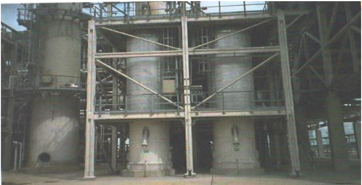
Рисунок 3.5 - Установки и оборудование цеха изомеризации ТОО «ПКОП»
